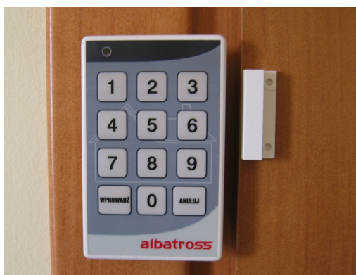
Rysunek 14 Poprawnie zamontowana klawiatura i czujnik otwarcia drzwi.
